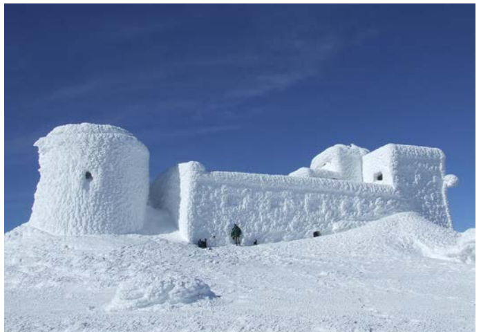
Мал. 31. Присипані товстим шаром снігу залишки колишньої астрономічної обсерваторії на горі Піп Іван у Верховинському районі
