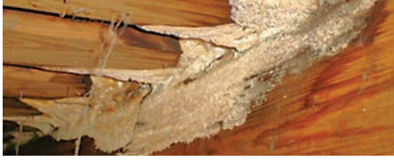
Мал. 235. Дерев'яна будівля, уражена домашнім грибом
